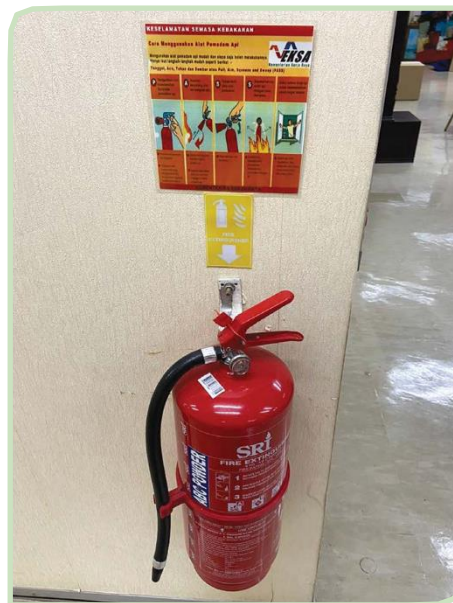
Rajah 40: Peralatan Pencegahan Kebakaran
