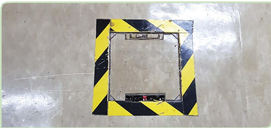
Rajah 23: Lantai yang tidak rata ditampal dengan pelekat amaran
