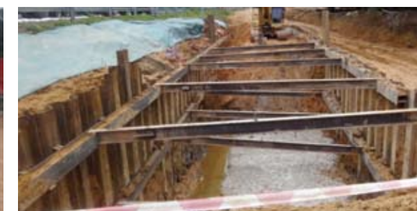
Kerja-kerja penyediaan sistem perlindungan sementara untuk pembinaan tembok penahan RC di kawasan tambahan
