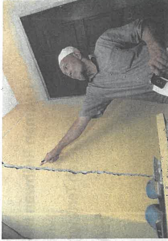
SEORANG penduduk menunjukkan kesan retakan pada dinding Blok F Pangsapuri AUI, Taman Keramat Permai semalam.
