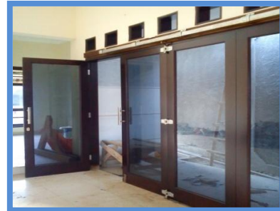
Penambahan pintu tertakluk kepada garis panduan PBT
