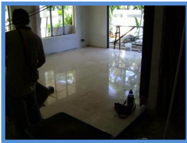
Memasang jubin lantai dan dinding luar dengan luas keseluruhan tidak melebihi daripada 6.5 meter persegi
